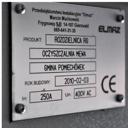
Tabliczka na rozdzielnicę
