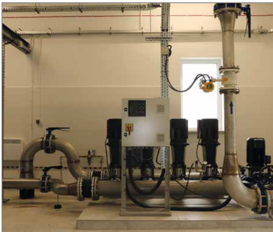
Pokazowa dziś stacja uzdatniania wody w Kosewie. Pozyskanie środków finansowych na wymianę urządzeń wodociągowych w gminie na nowe - to nasza strategia na najbliższe miesiące
